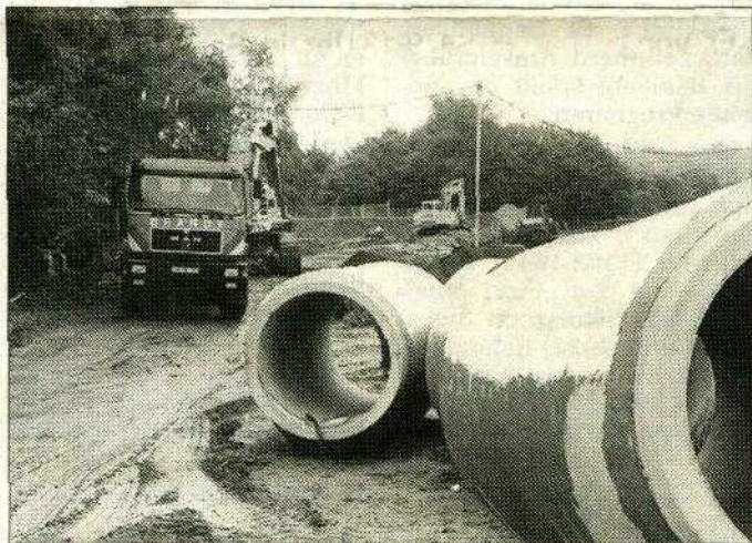
Diese Baustelle ist Ziel von Randalierern. Die Zerstörungen stören den Arbeitsablauf. Foto: G. Goldstein
